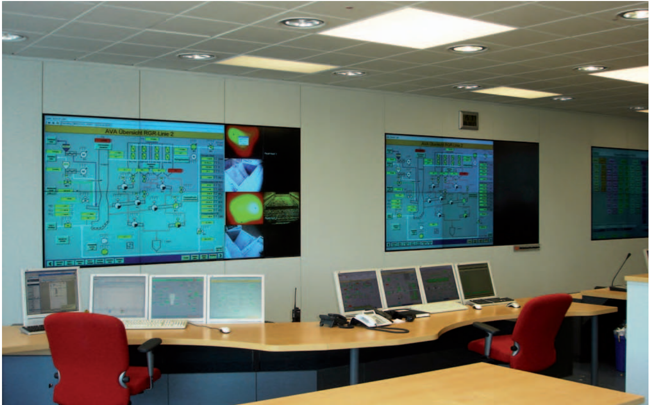
Warten und Leitstände für Prozessführungen. Ein verantwortungsvolles Arbeitsumfeld, in dem ein störungsfreies Arbeiten Bedingung ist.
