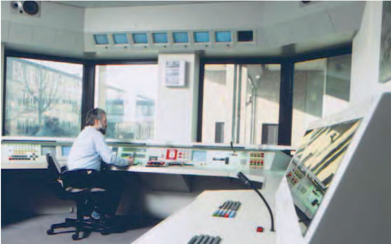
Eine Werkschutzzentrale zur Überwachung und Führung einer komplexen Sicherheitsanlage. Ein Arbeitsplatz, der auf engem Raum umfangreiche Kommunikationsmittel und Steuerungseinrichtungen für sicherheitstechnische Systeme enthält.
