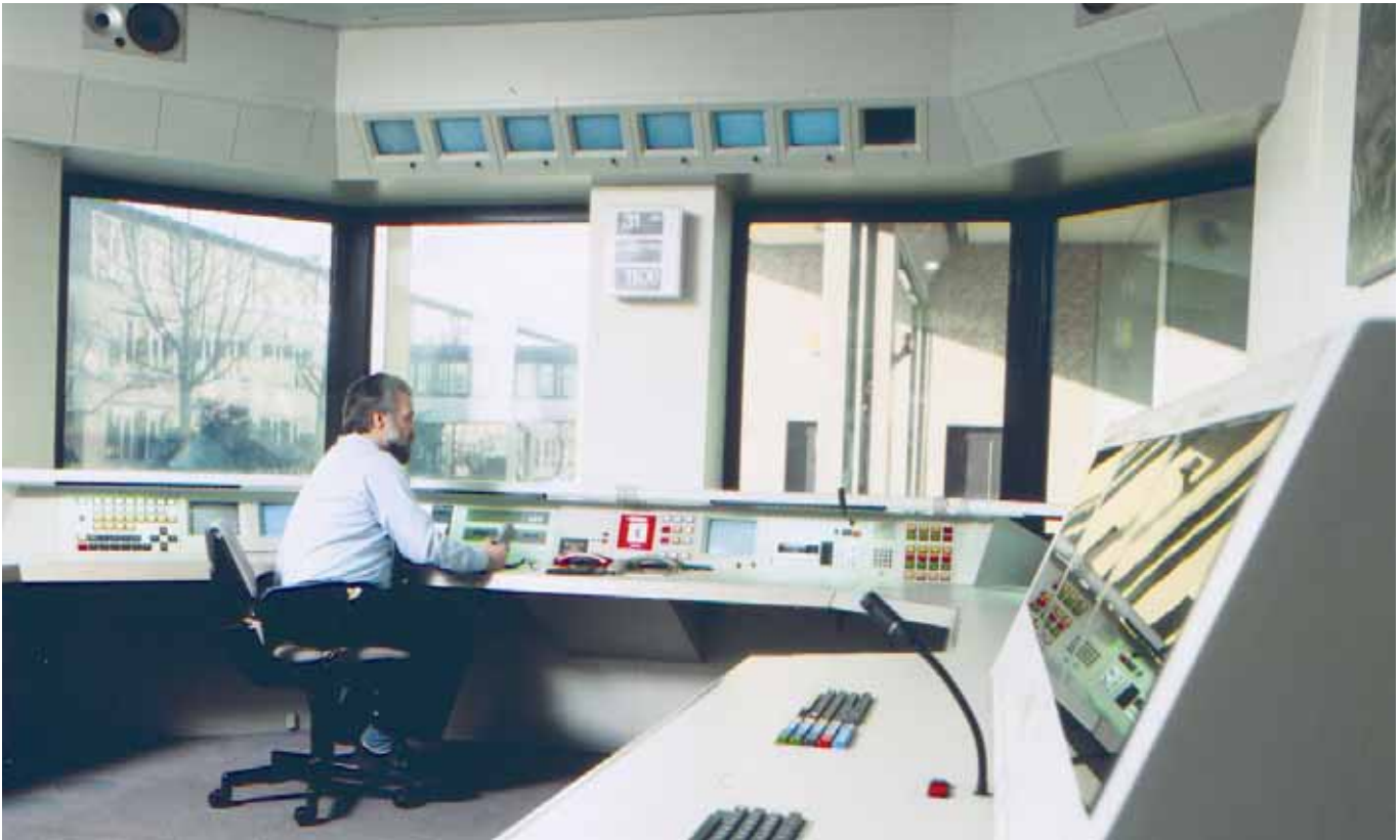
Eine Werkschutzzentrale zur Überwachung und Führung einer komplexen Sicherheitsanlage. Ein Arbeitsplatz, der auf engem Raum umfangreiche Kommunikationsmittel und Steuerungseinrichtungen für sicherheitstechnische Systeme enthält.
